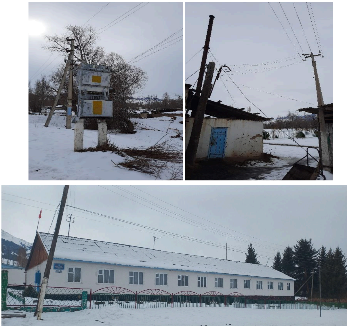
Рис.15 – ТП 100/10/0,4 и воздушные линии электропередачи
