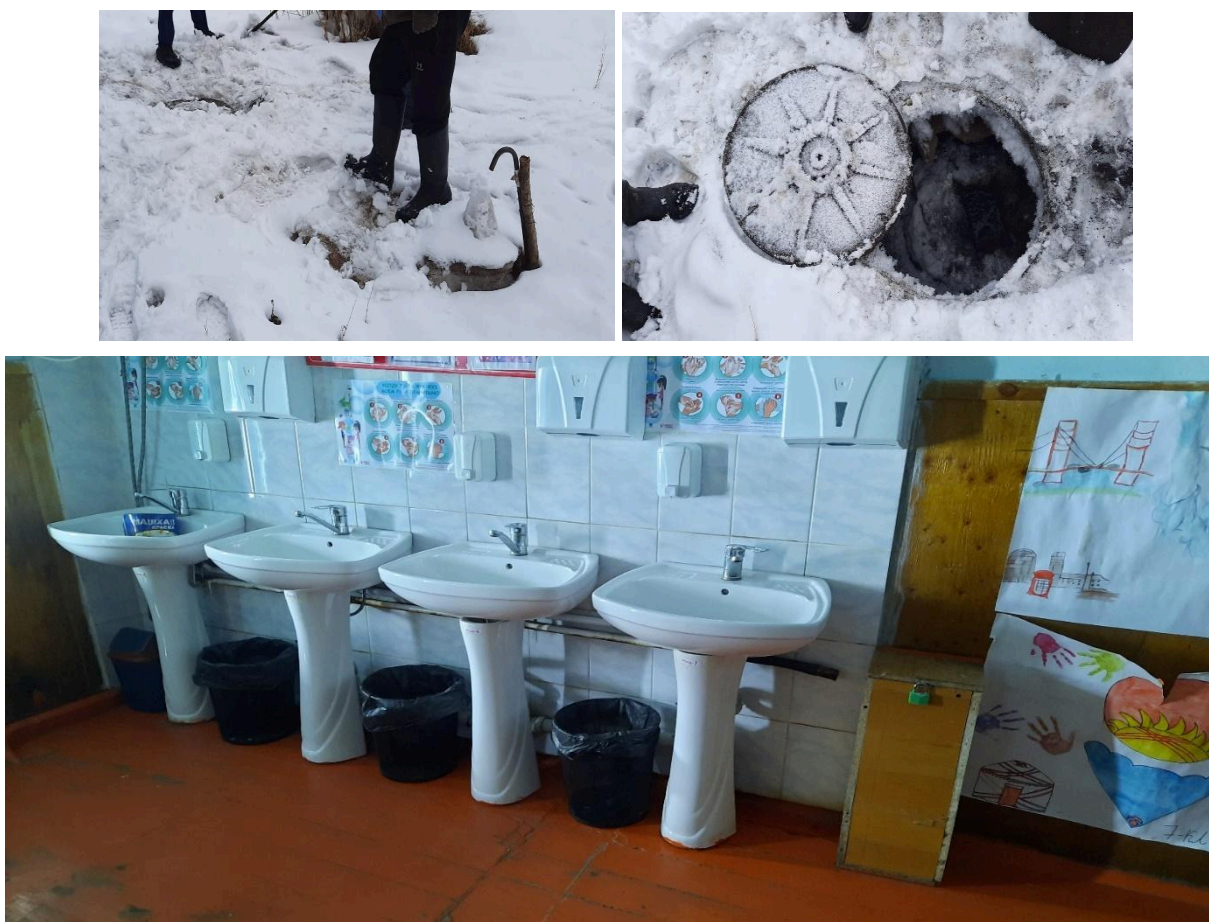
Рис.14 –водопровод и умывальники
