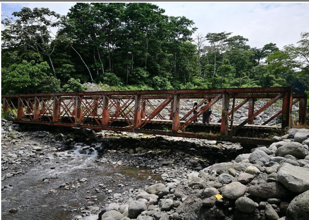
Fotografía 1. Ruta N° 231 puente sobre el río ventura ubicado a 1.3 km aguas arriba del inicio de concesión. En primer plano se observa nivel de colmatación de material a escasos 1.5 m de la superficie de ruedo del puente; y estado de deterioro de las bases del mismo. En segundo plano se muestra dique de contención elaborado por la CNE y vegetación riparia en las zonas de protección.
