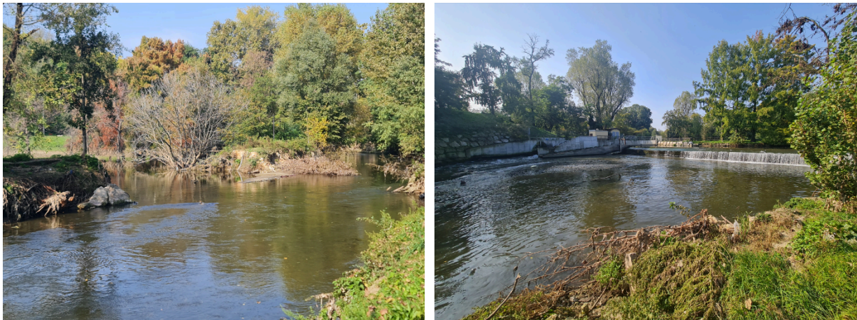
Figura 6.1 – Porzione finale del tratto 27 con argine crollato e briglia di monte
