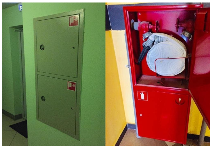
Рисунок 1- Внутренний противопожарный водопровод в здании
