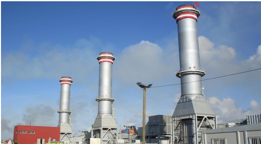
Figure 2 : Centrale Turbine à Gaz Mohammedia M2 (3*100 MW)
