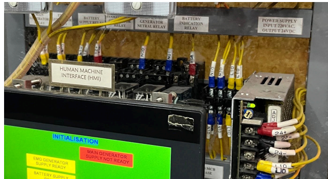
Gambar 4.2 Kondisi B Main Generator (Sumber: Dokumentasi Pribadi)
