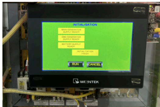
Gambar 3.19 Kondisi A Emergency Generator (Sumber: Dokumentasi Pribadi)
