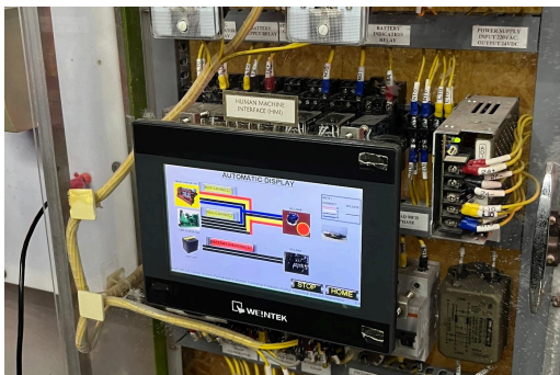
Gambar 4.5 Kondisi Running A Main Generator (Sumber: Dokumentasi Pribadi)
