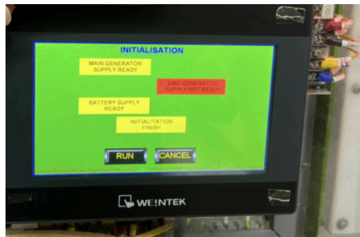
Gambar 4.4 Kondisi B Emergency Generator (Sumber: Dokumentasi Pribadi)
