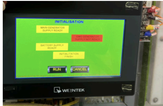
Gambar 3.20 Kondisi B Emergency Generator (Sumber: Dokumentasi Pribadi)
