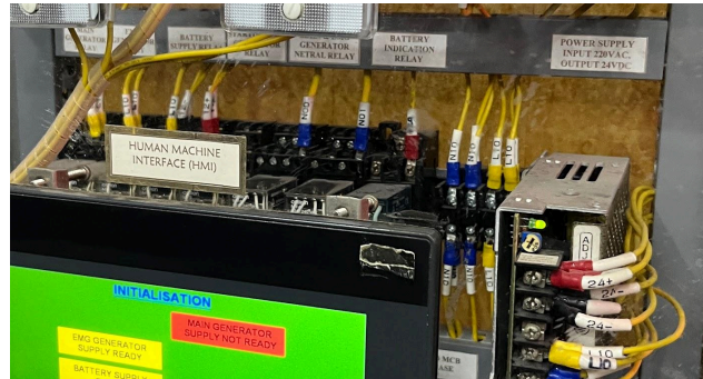
Gambar 4.2 Kondisi B Main Generator (Sumber: Dokumentasi Pribadi)
