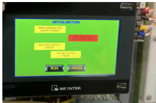
Gambar 4.4 Kondisi B Emergency Generator (Sumber: Dokumentasi Pribadi)
