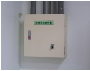
強制排煙系統
