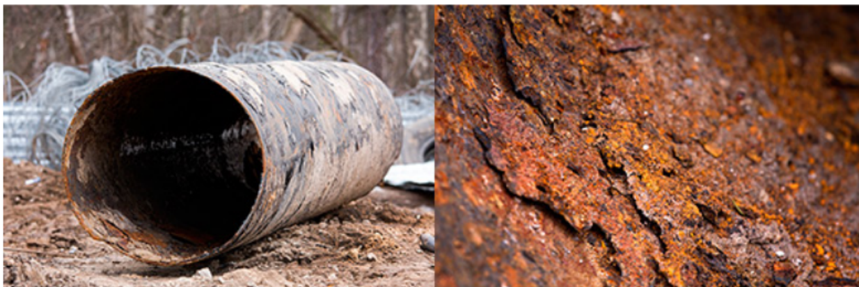
Рисунок 1 – Наслідки корозії промислових трубопроводів
