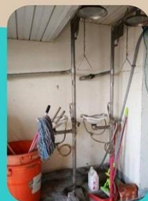
圖2.緊急沖淋裝置 擺放雜物且未維護
