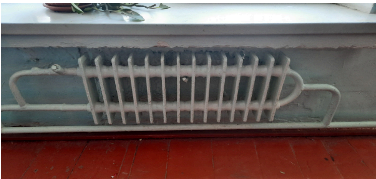
Фото 7. Тип пластинчатых радиаторов, установленных в корпусе № 2
