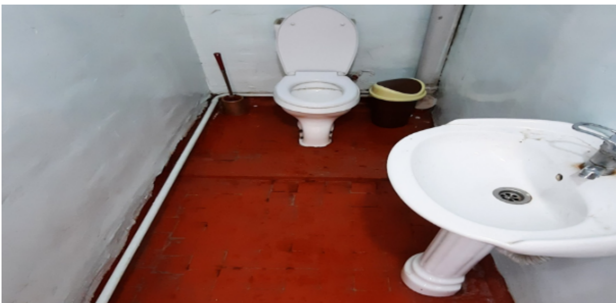
Фото 10. Санузел, подключенный к канализации
