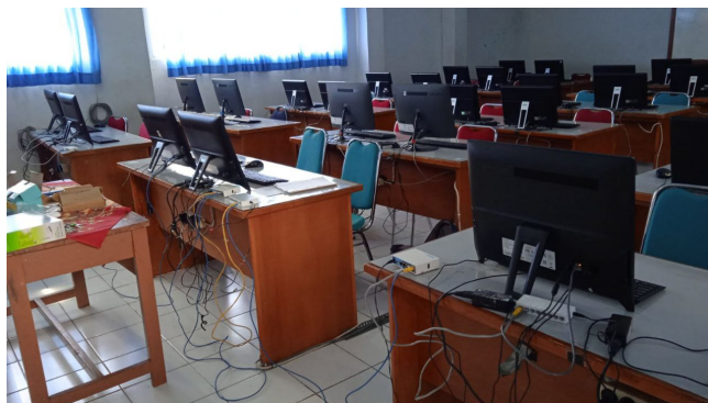
Fig. 21. Instalasi Perangkat Jaringan (1)
