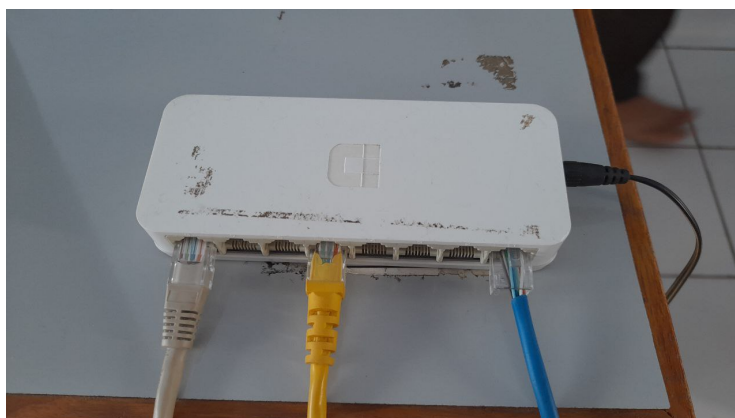
Fig. 23. Instalasi Perangkat Jaringan (3)
