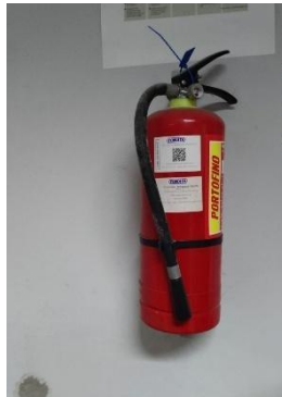
Gambar 23. Alat Pemadam Kebakaran (Sumber : Dokumentasi Pribadi)
