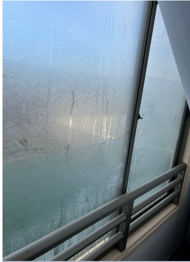
Imagen ilustrativa de Condensación en ventana por nula ventilación
