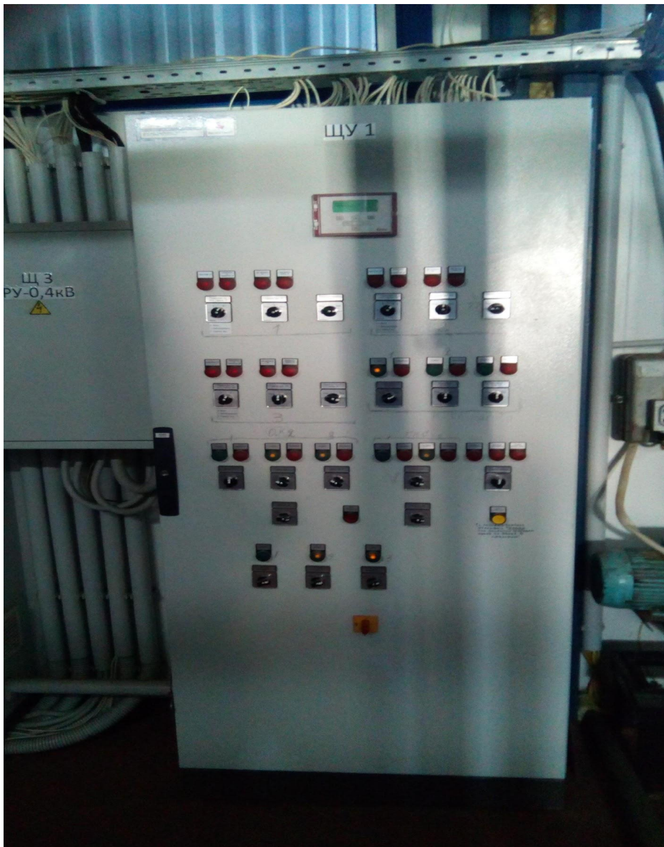
Котельная №4, ул.Промышленная,55, Шкаф автоматики.
