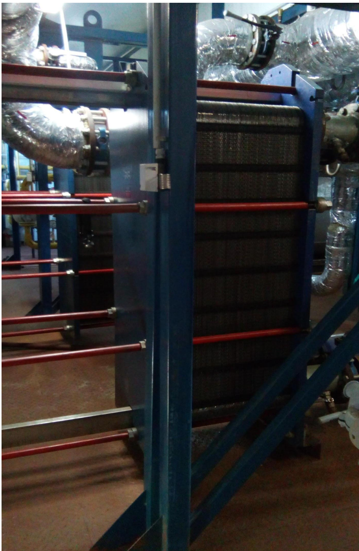
Котельная №4, ул.Промышленная,55. Теплообменный аппарат.
