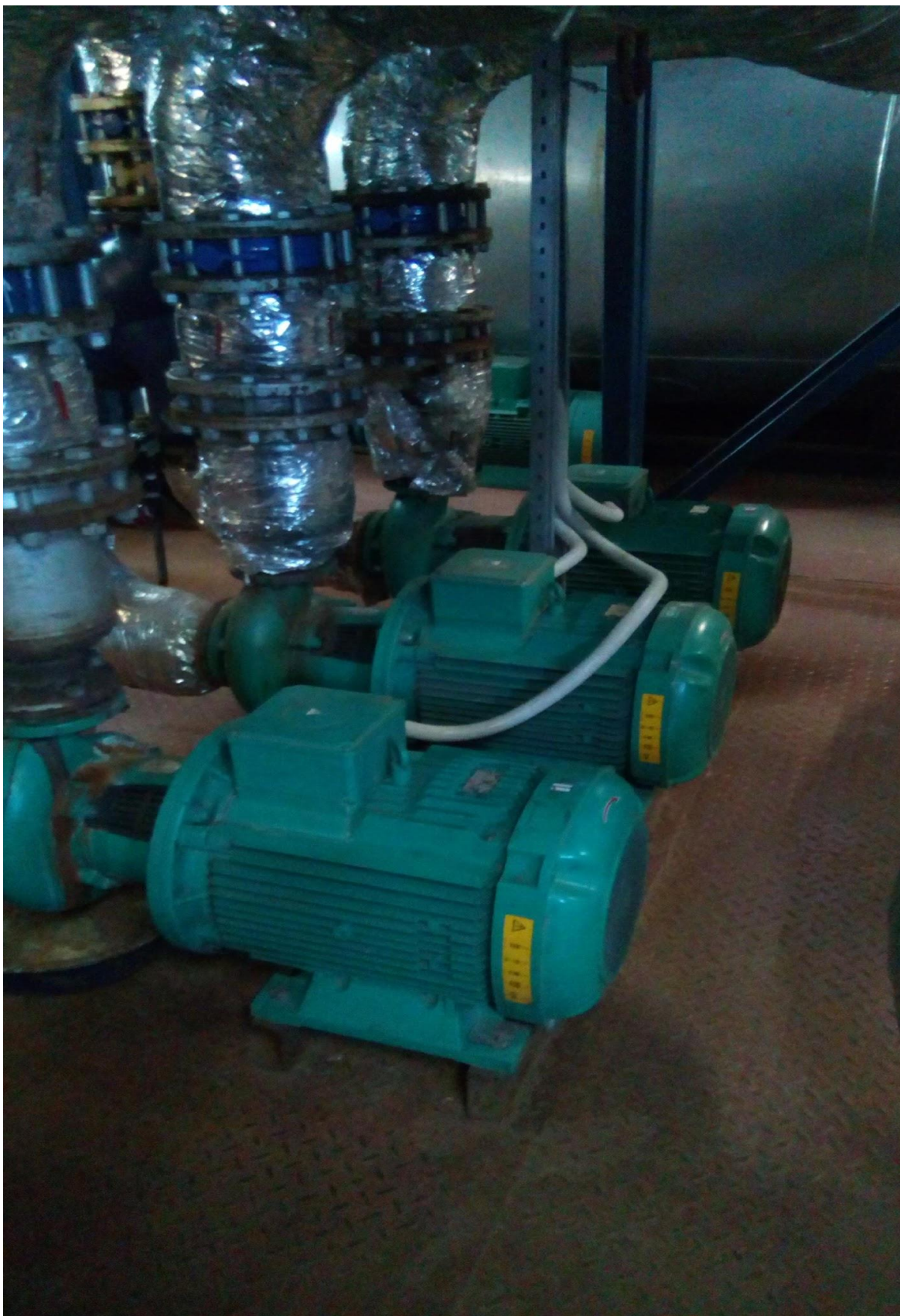
Котельная №4, ул.Промышленная,55. Насосное оборудование.
