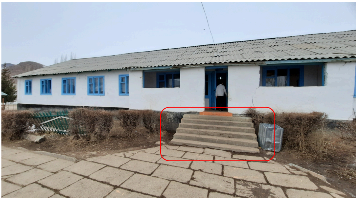
Фото 13. В корпусе №5 доступ ЛОВЗ ограничен, пандусы отсутствуют
