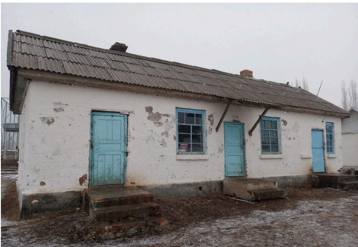
Фото 7– Вид на корпус 7. Технические помещения
