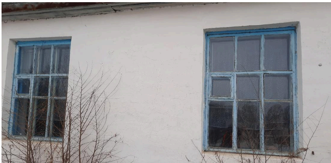
Фото 19 – . общий вид и состояние существующих окон Корпуса №4.
