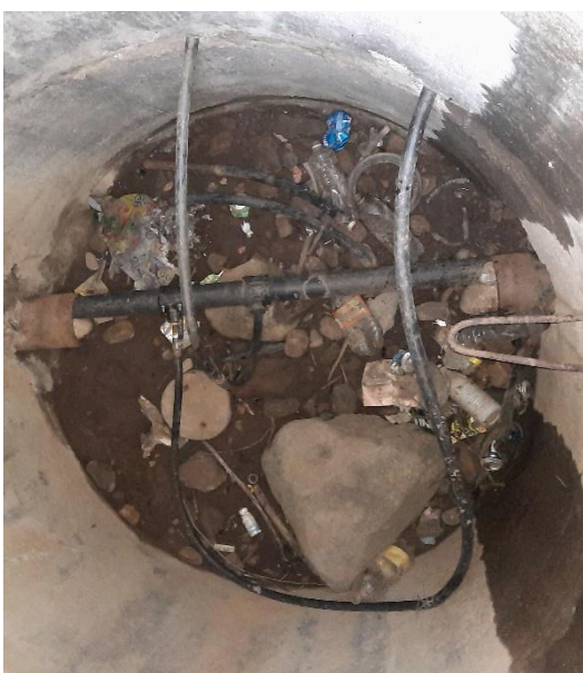
Фото 26,27. Сельская водопроводная сеть
