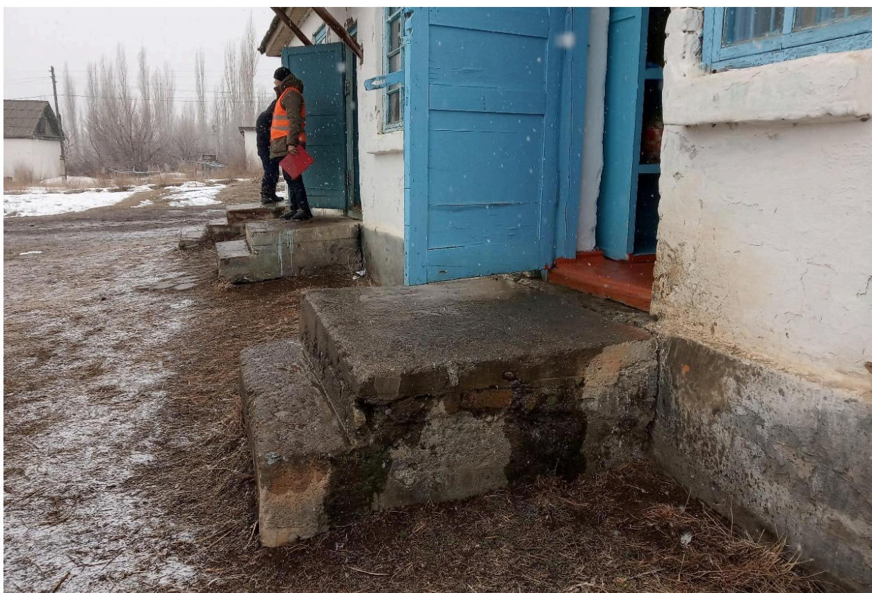
Фото 14. В корпусе №7 доступ ЛОВЗ ограничен, пандусы отсутствуют
