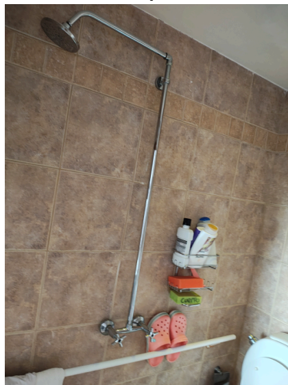
Figura 6. Tubería expuesta de la ducha.
