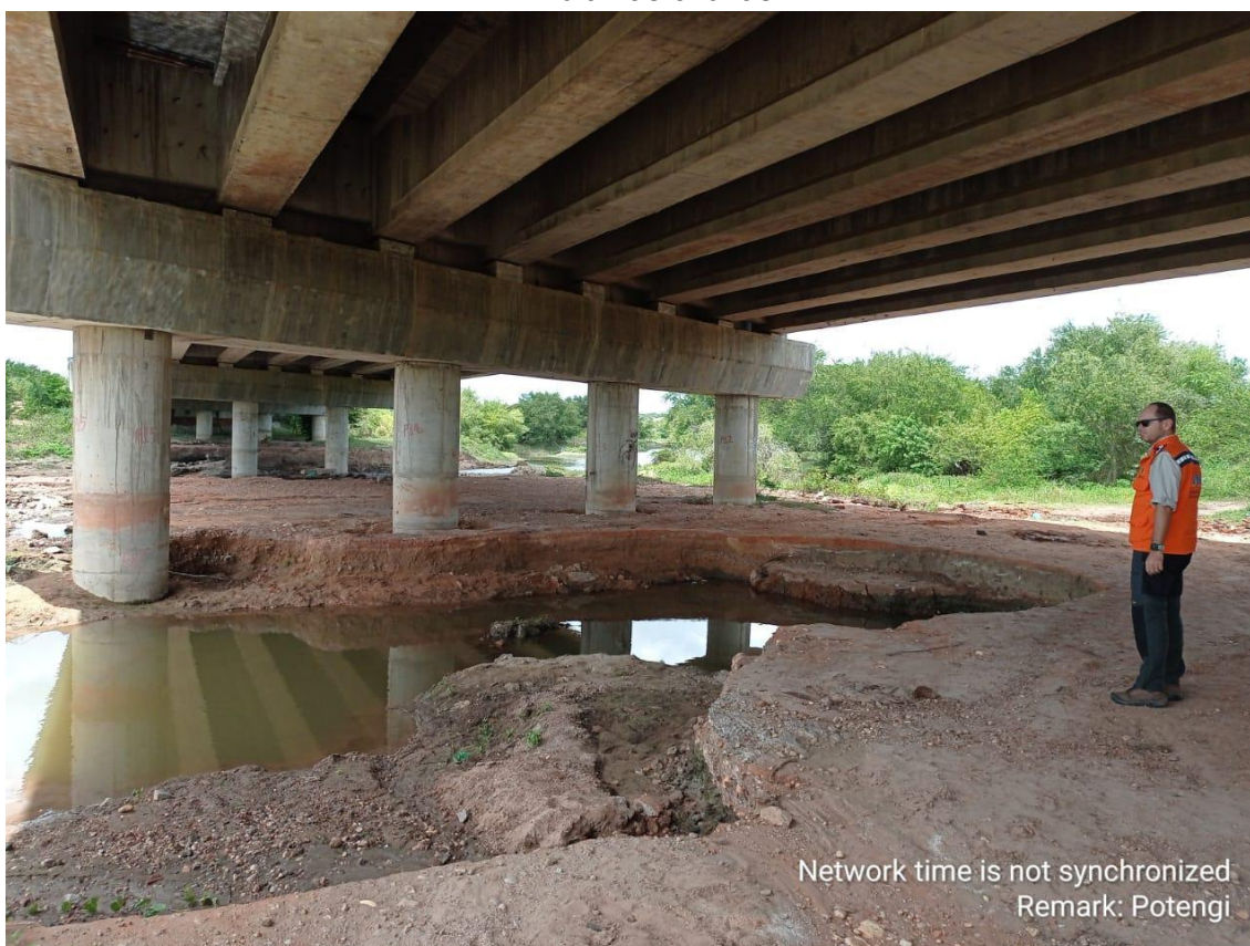
Figura 4 – Área licenciada para extração de areia em Guanduba. Erosão ocasionada pelas últimas chuvas.
