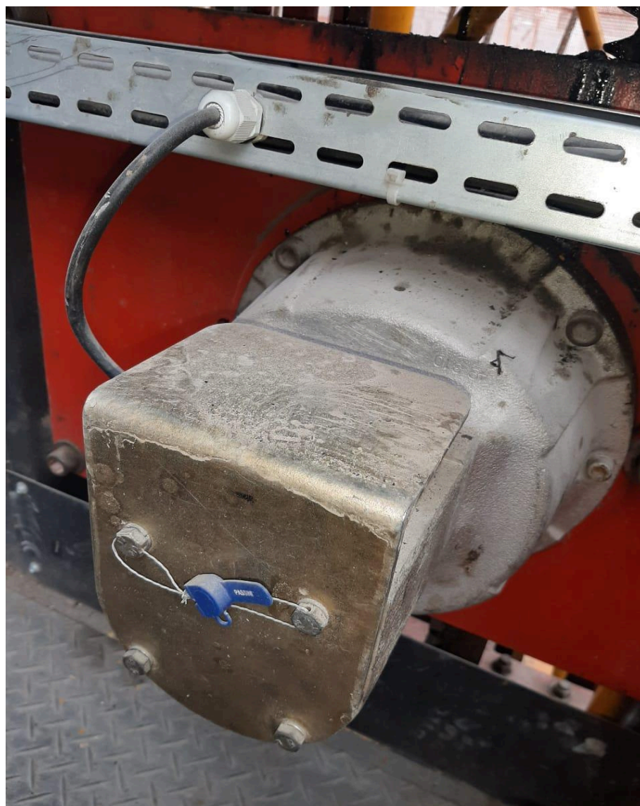
Figura 17 - Freio de segurança centrífugo inspecionado. Fonte: Autor
