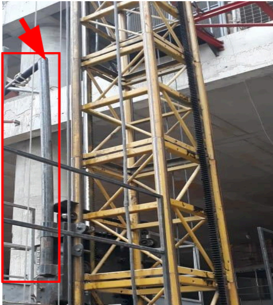
Figura 24 - Pau de carga do elevador de cremalheira. Fonte: Autor
