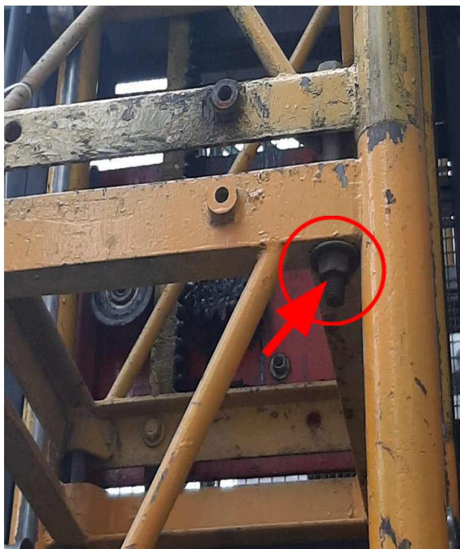
Figura 30 - Parafuso da torre sem contra porca e torqueamento. Fonte: Autor
