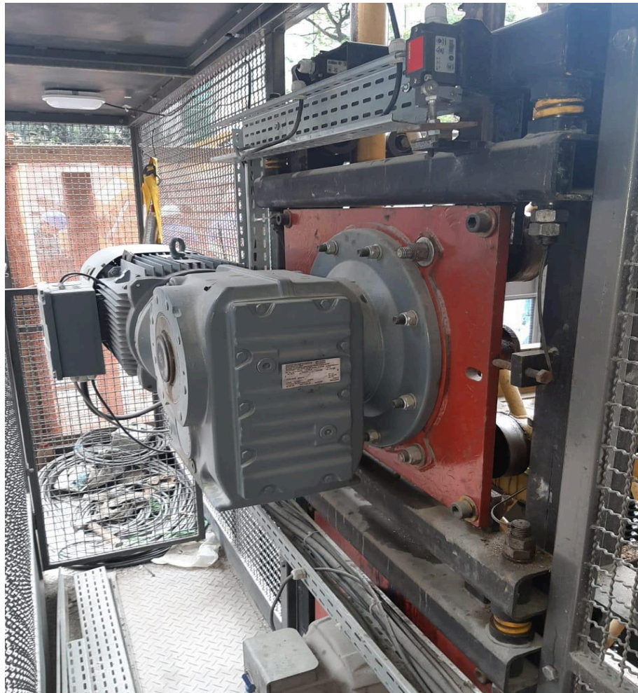
Figura 14 – Máquina motriz - Composto por motor, eletro freio e caixa redutora do elevador de cremalheira. Fonte: Autor
