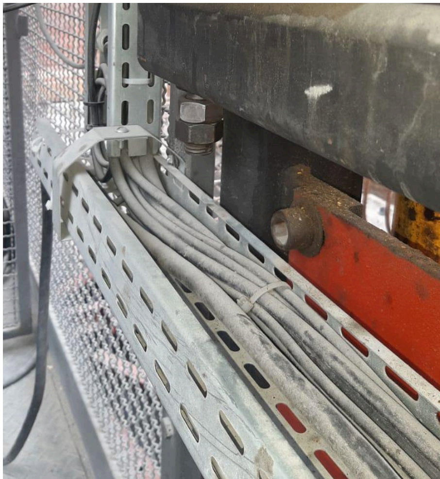
Figura 21 - Cabos elétricos do elevador de cremalheira. Fonte: Autor
