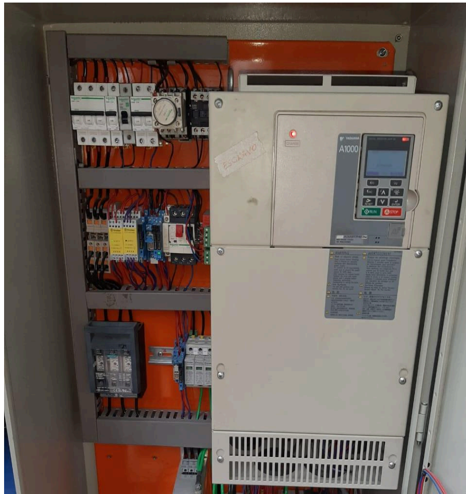
Figura 22 - Painel elétrico do elevador de cremalheira. Fonte: Autor
