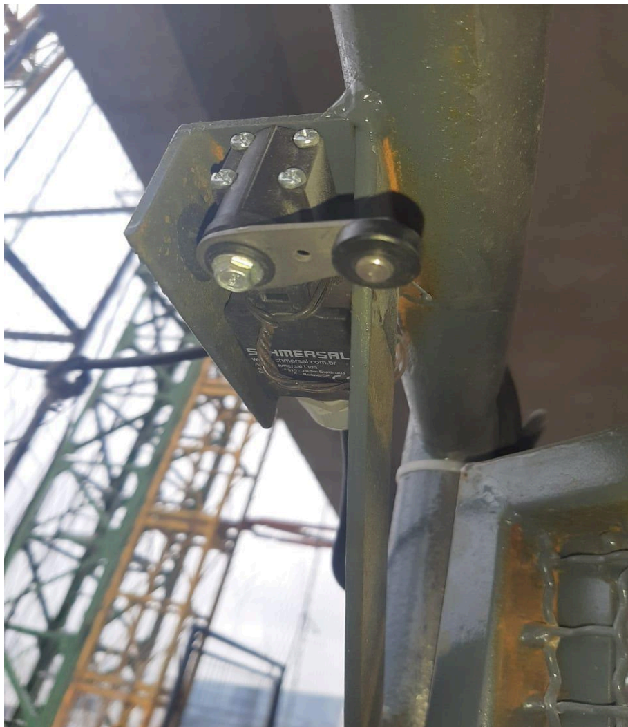
Figura 31 - Fim de curso da porta de pavimento jumpeada. Fonte: Autor
