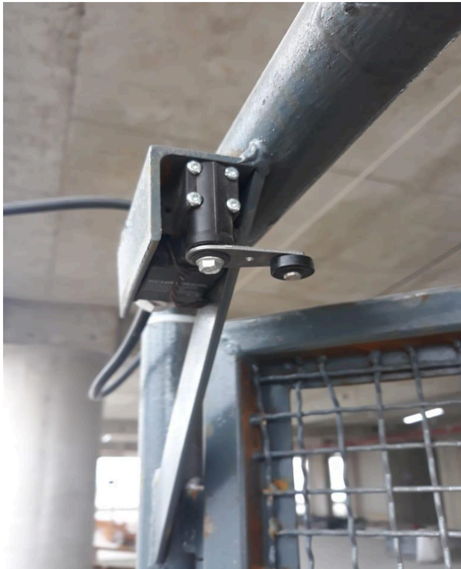
Figura 9 - Dispositivo de segurança jumpeado. Fonte: Autor
