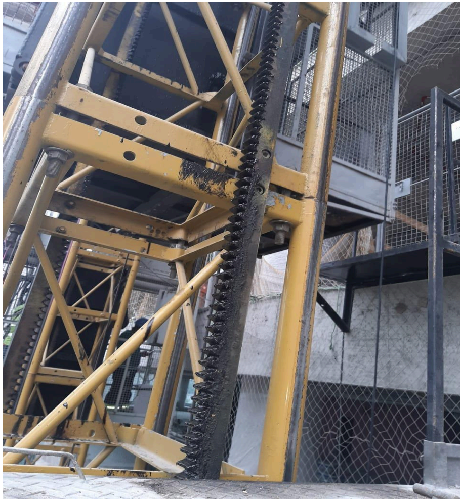
Figura 6 - Partes da torre do elevador de cremalheira. Fonte: Autor
