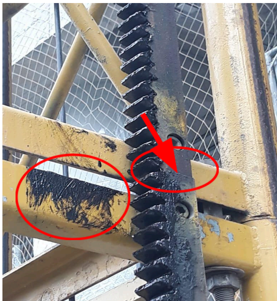
Figura 10 - Seção da torre desalinhada. Fonte: Autor
