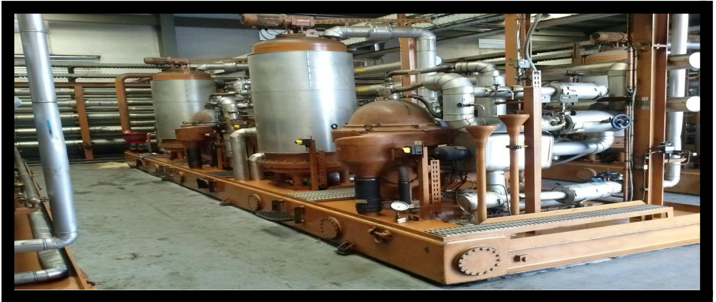
Figure 10 : Photo d'un skid
