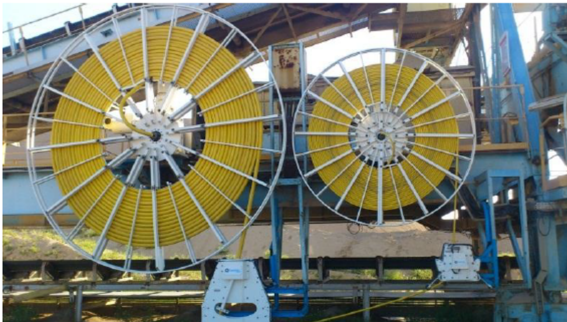
Figure 5: enrouleur de puissance et de commande
