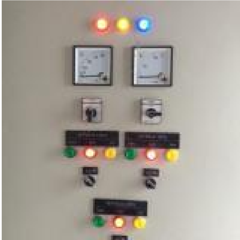
HÌNH TỦ ĐIỆN MCC-T7-RF-MV1
