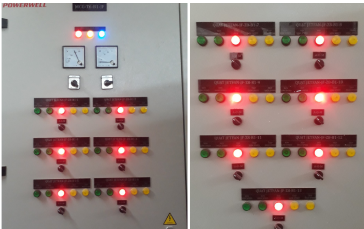
MẶT NGOÀI BỐ TRÍ NÚT ĐIỀU KHIỂN VÀ ĐÈN BÁO HÌNH TỦ ĐIỆN MCC-T7-B1-JF
