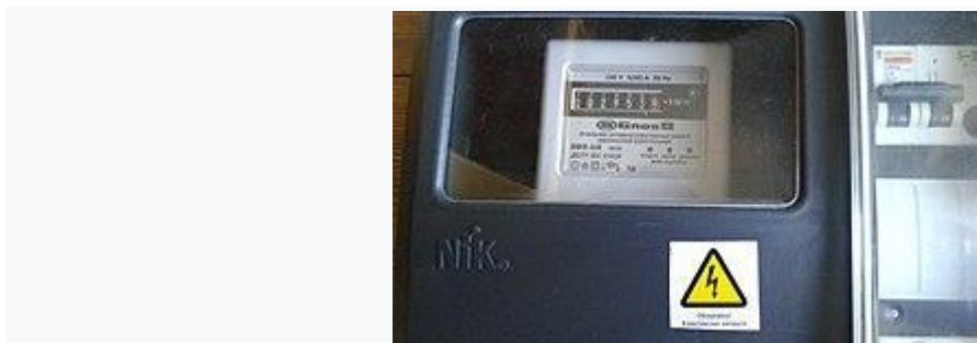
Знак небезпеки «Електрична напруга » (DIN 4844-W 8) на електроштиті
