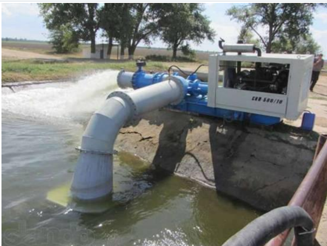
Рис.6. Дизельна насосна станція СНП-500/10
