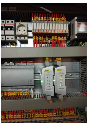
Edificio Arrupe sala técnica. Cuadro de control.
