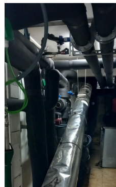
Edificio Antxieta. Colector
