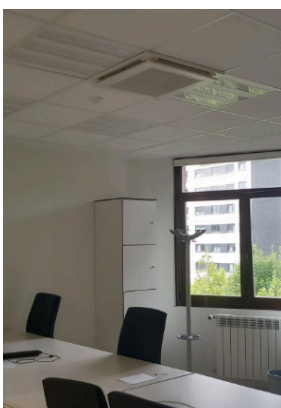
Edificio Antxieta. Fan coil de techo en sala de reuniones
