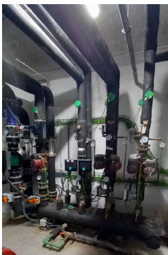
Edificio Larramendi. Colector
