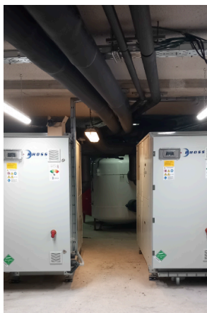
Edificio Arrupe. Sala técnica. Bombas de calor geotermia
