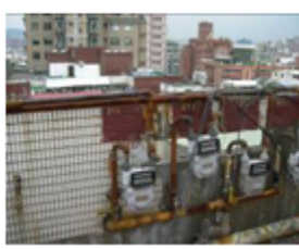
屋頂瓦斯表及管線
