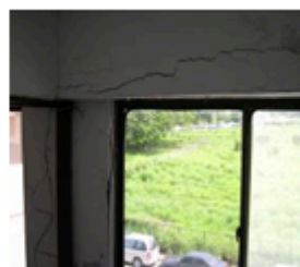
梯廳樑柱龜裂
