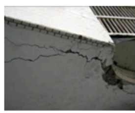
外牆鋼筋外露
