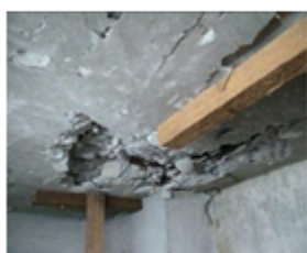
天花板鋼筋外露
