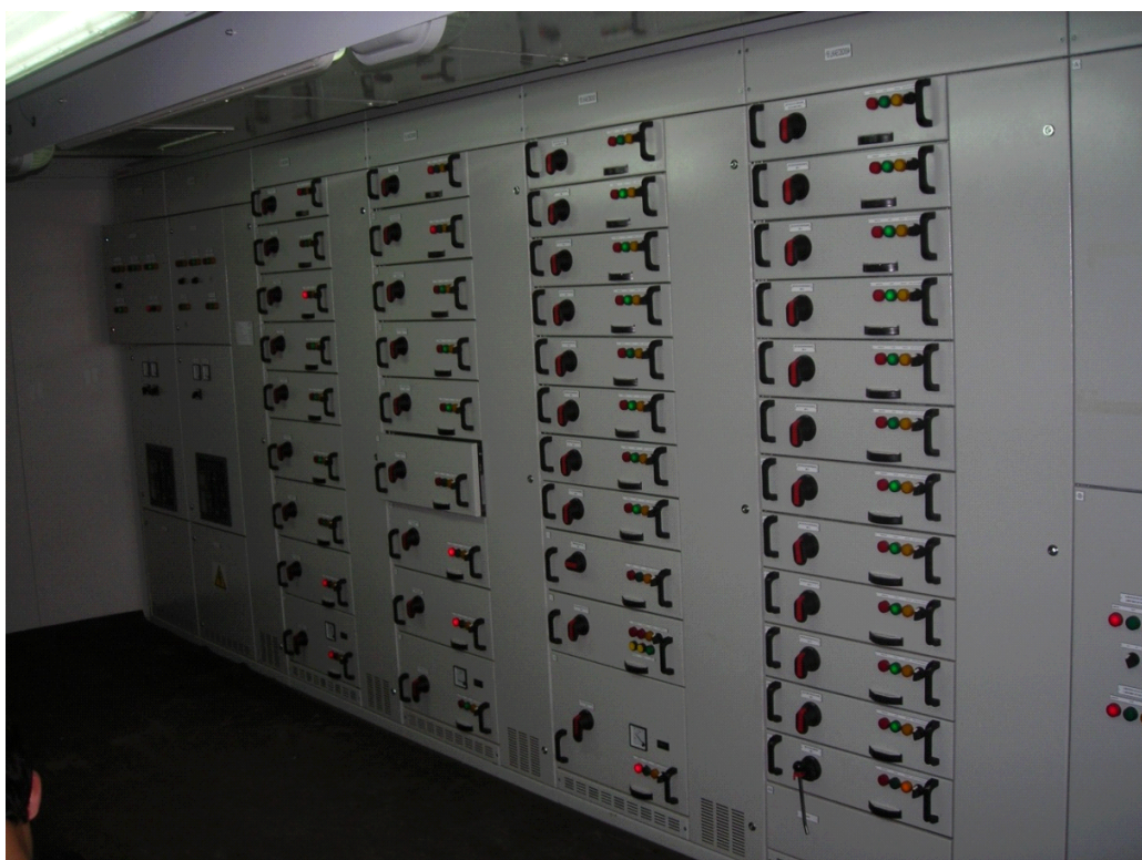
Figure2 : salle de commande.
