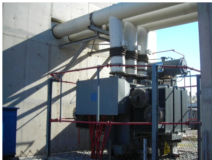
Figure : Transformateur de soutirage
