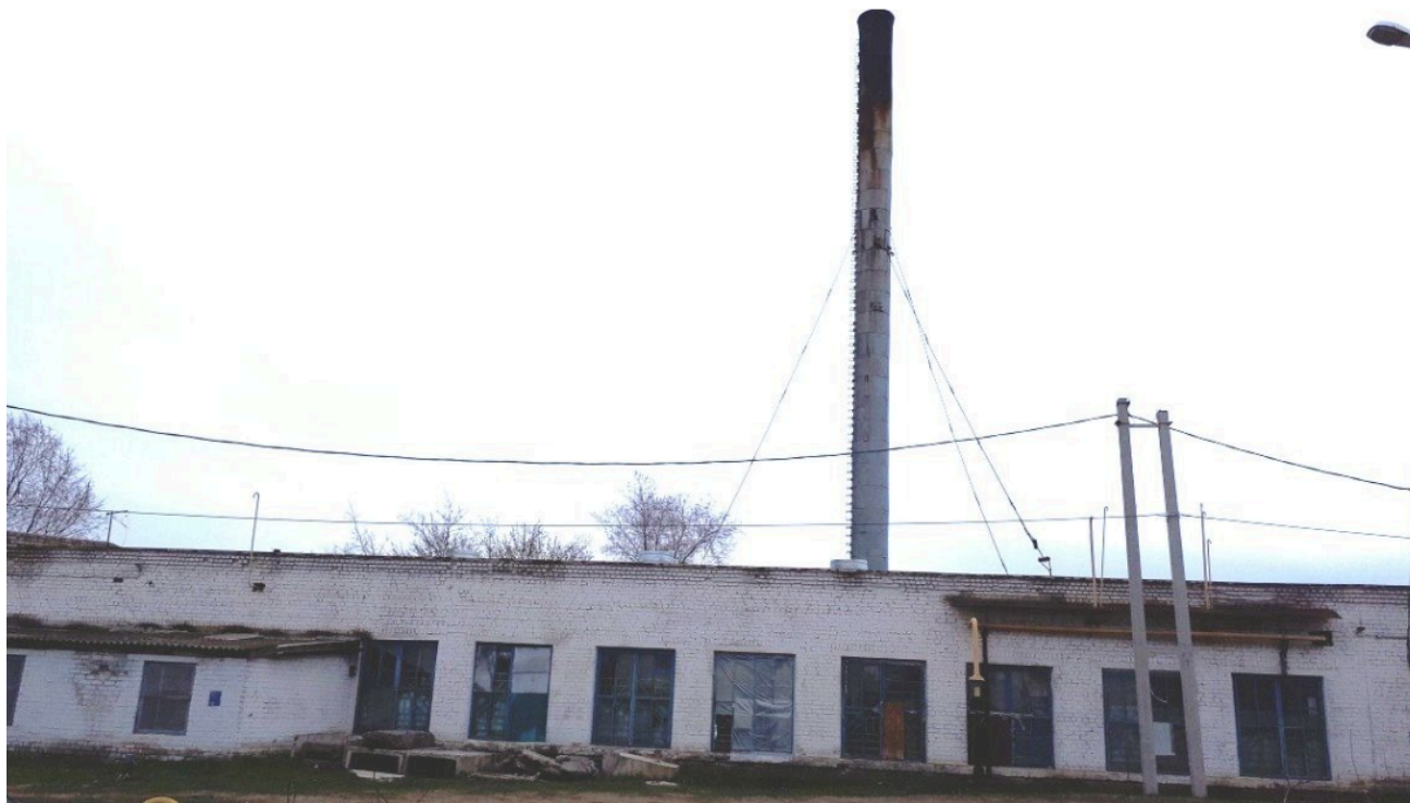
Рис 4 – Централизованная котельная ЦРБ (по адресу г. Калач-на-Дону, ул. Кирова, 172а) Зона теплоснабжения в границах ул. Кирова, ул. Маяковского, ул. Пархоменко, ул. Пролетарской, пер. Московский, пер. Волгоградский.
