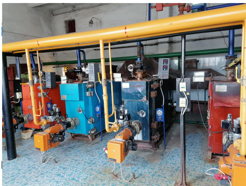
Рис. 7 Водогрейные Котлы КВа-0,63Гн, установленные в Котельной № 3 г.Калач-на-Дону
