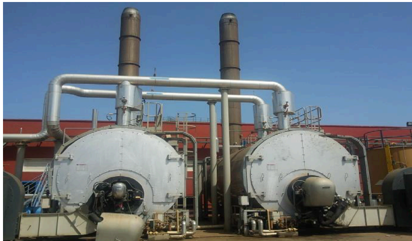
Figure 7 : Les deux chaudières de la centrale turbine à gaz de Mohammedia
