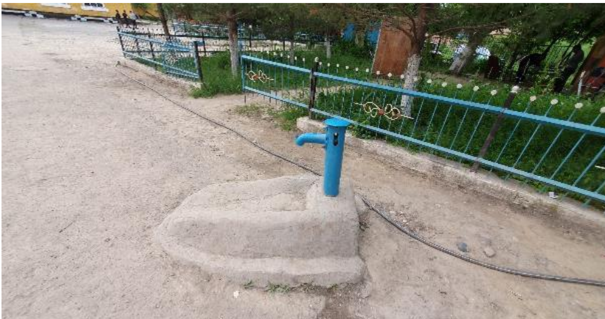
Фото 8. Водопроводный кран в нерабочем состоянии
