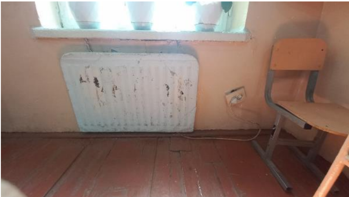
Фото 5. Система отопления школы. Бетонные электроконвекторы
