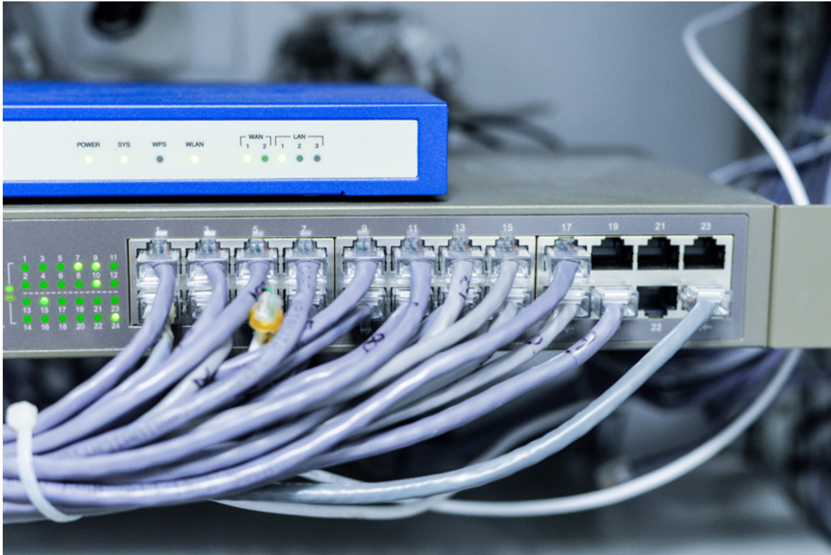
Ejemplo de switch de 24 puertos.
