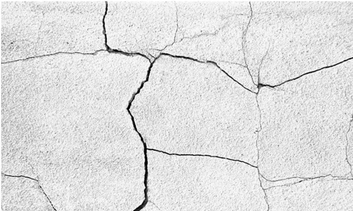
Nền bê tông bị nứt (3)
