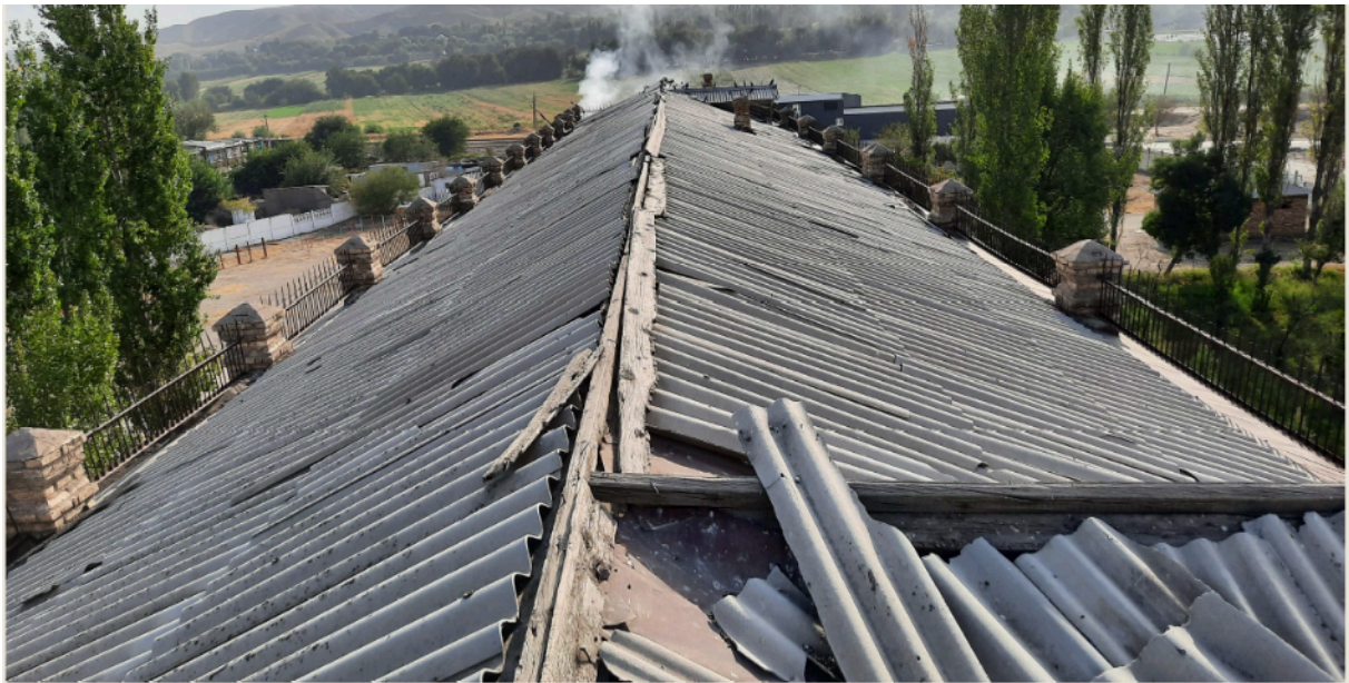
Фото 11. Кровля Блока 1 покрыта шифером с АСМ, состояние неудовлетворительное
