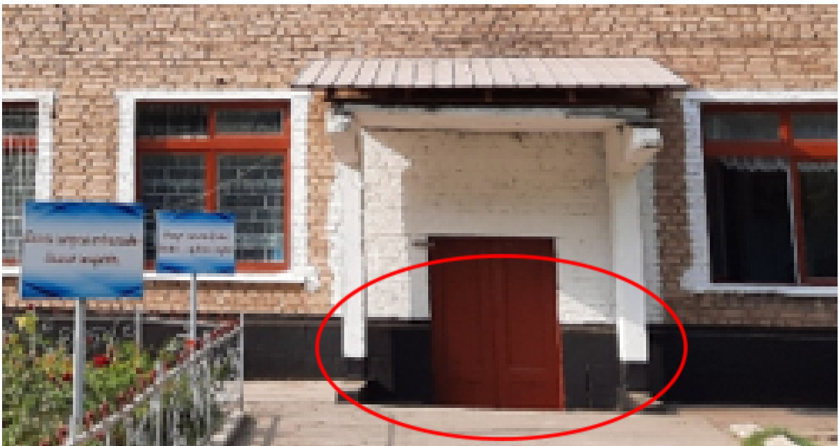
Фото 13. У входа с улицы в Блок 1 отсутствует пандус
