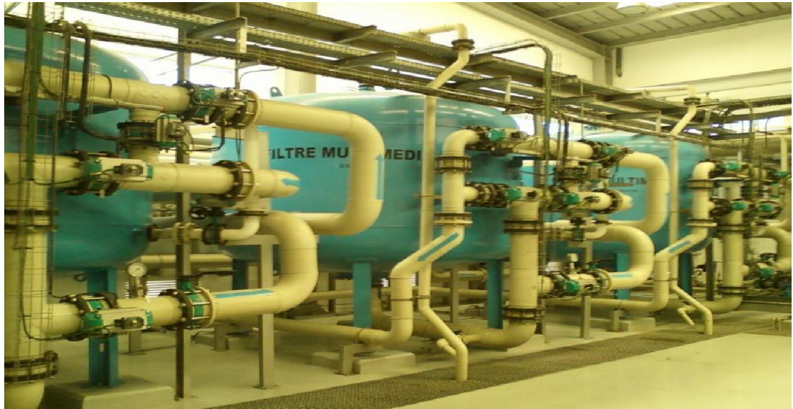
Figure 7 : Les filtres multimédia
