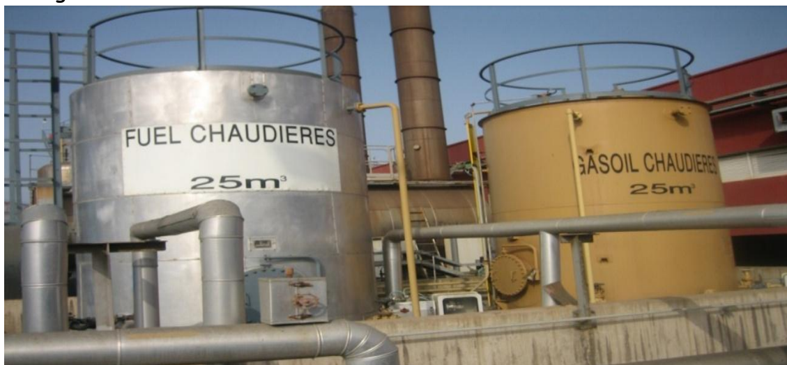
Figure 36 : Réservoirs fuel et gasoil de la chaudière (25m³ chacune)
