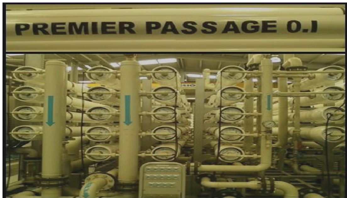
Figure 9 : premier passage osmose inverse
