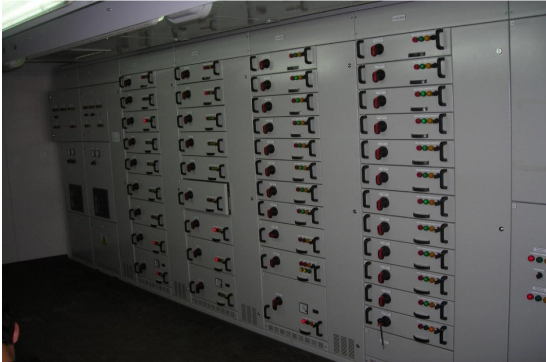
Figure 23 : salle de commande
