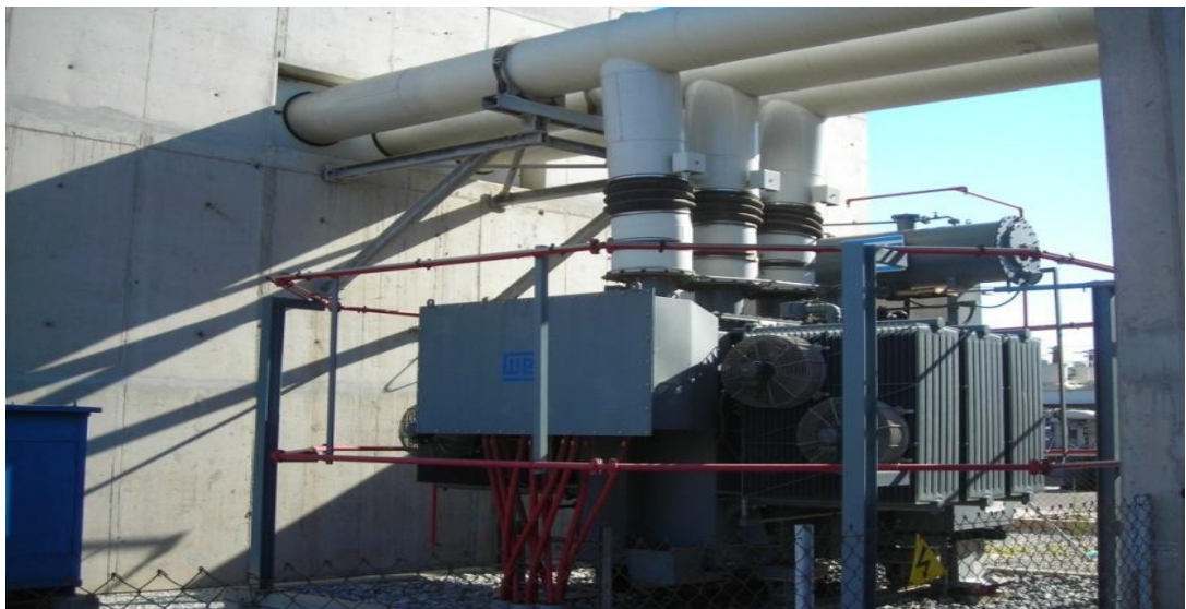
Figure 34 : Transformateur de soutirage
