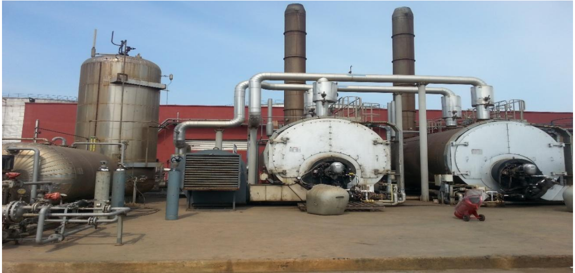
Figure 35 : les deux chaudières d'eau surchauffée de la central TAG2
