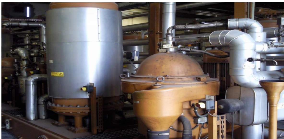
Figure 17 : poste traitement fuel
