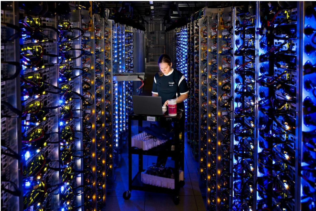
Рисунок 9 - Інженер обслуговує обладнання в центрі обробки даних [23]
