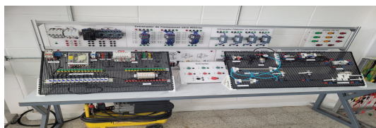
Fig. 1: Vista general del entrenador didáctico electroneumático construido
