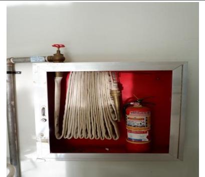
Dry stand pipe
