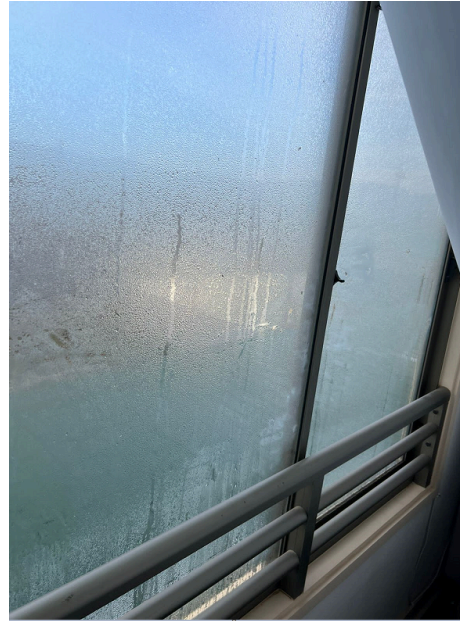
Condensación en ventana por nula ventilación
