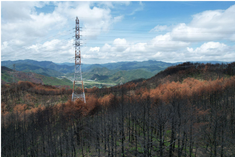
사진. 울진삼척 산불 피해지 내 365kv 송전선로
