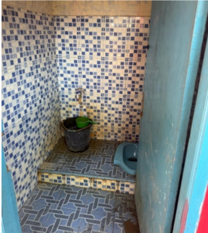
Gambar 1. Kondisi awal tempat wudhu sebelum pembangunan
