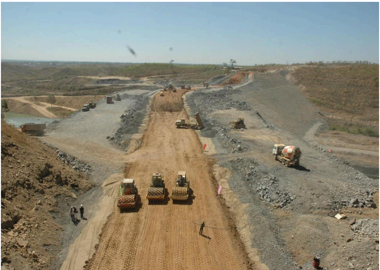
Thi công lớp nhựa AC tại dự án đường cao tốc Cầu Giẽ - Ninh Bình
