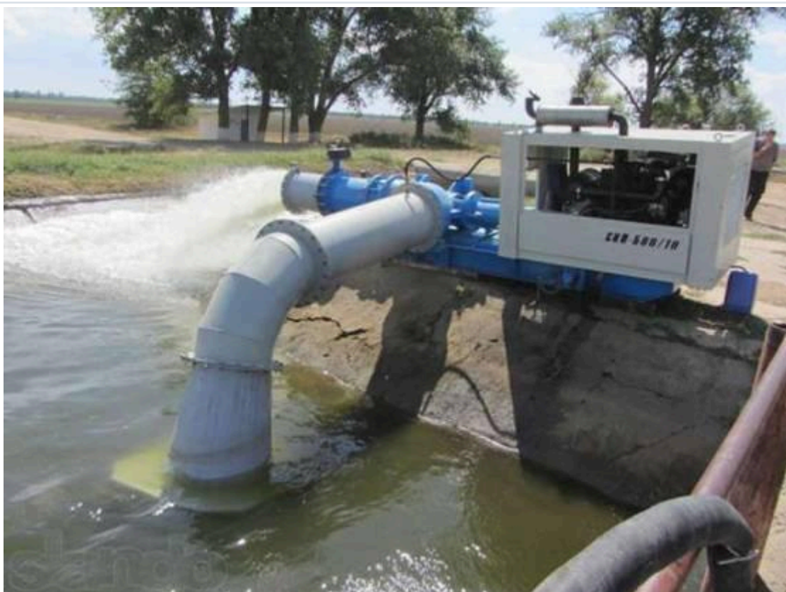
Рис.6. Дизельна насосна станція СНП-500/10
