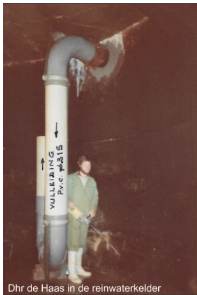
Dhr de Haas in de reinwaterkelder
