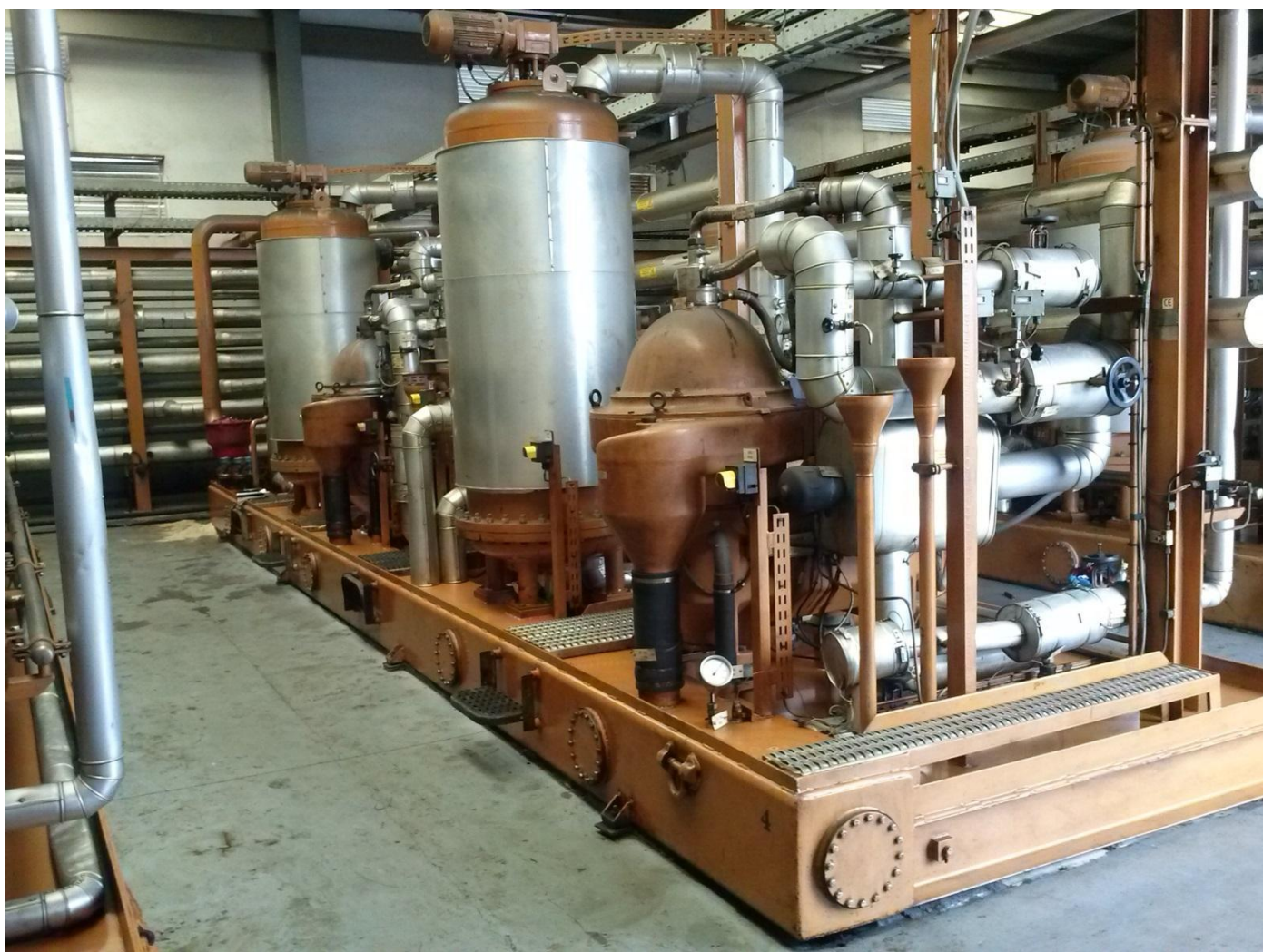
Figure 9 : Photo d'un skid
