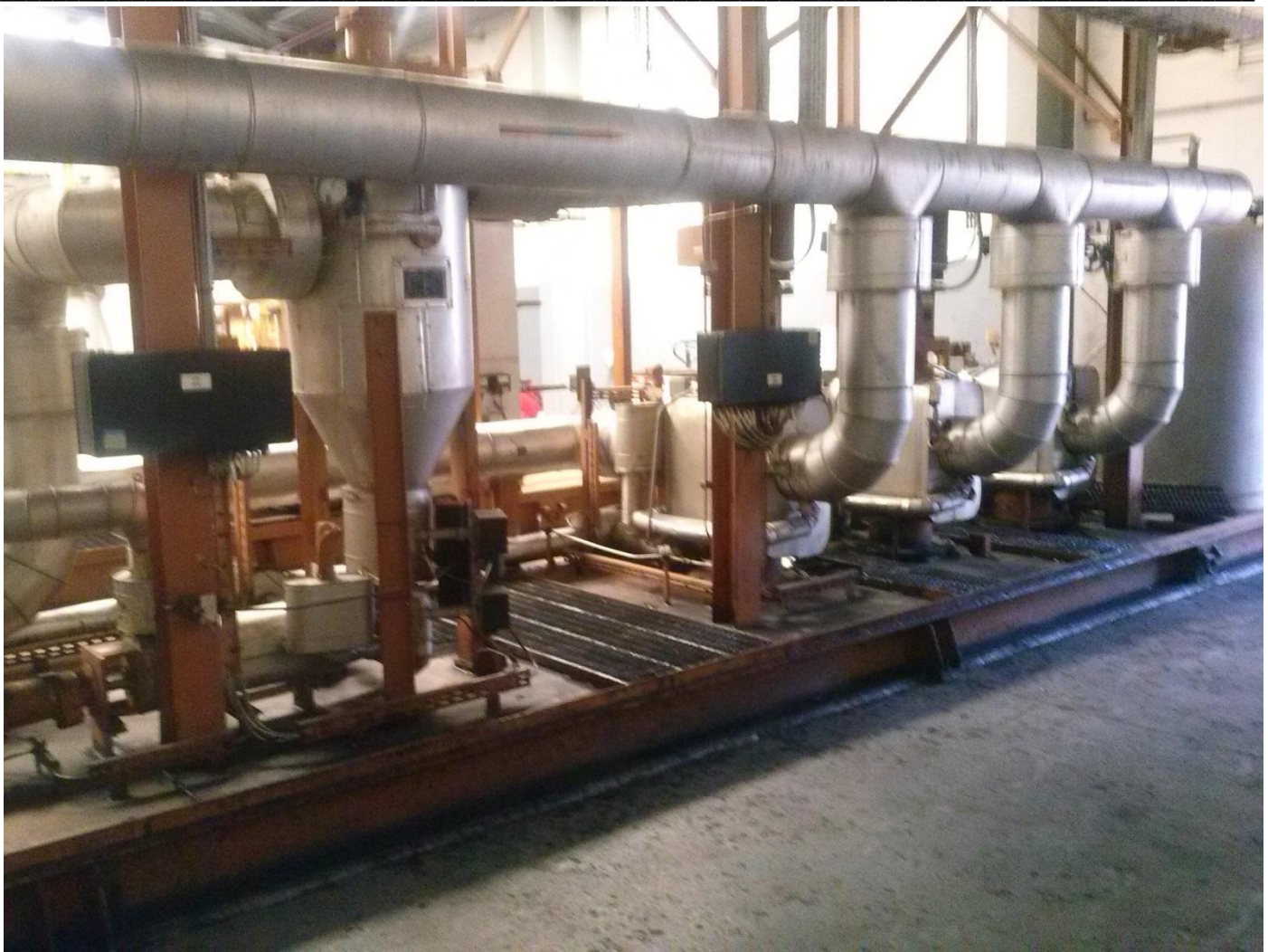
Figure 8 : photo d'un filtre et 3 pompes de déplacement
