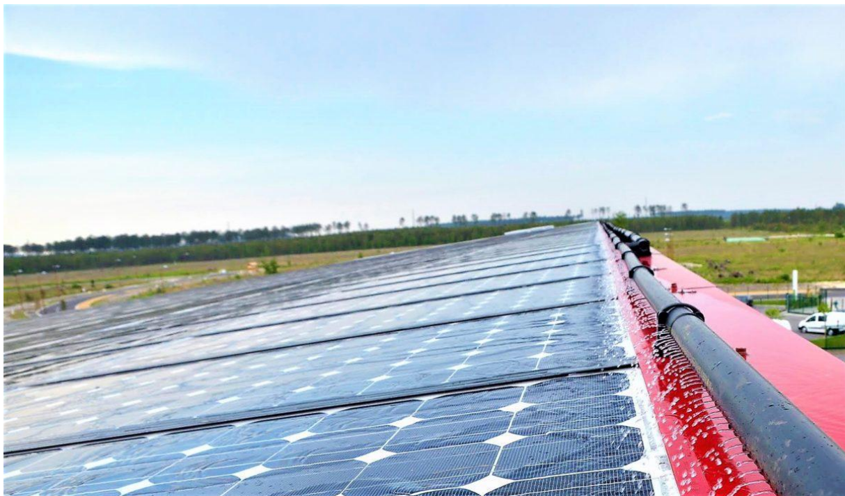
Figure 5 : Arrosage d'un panneau photovoltaïque [10]
