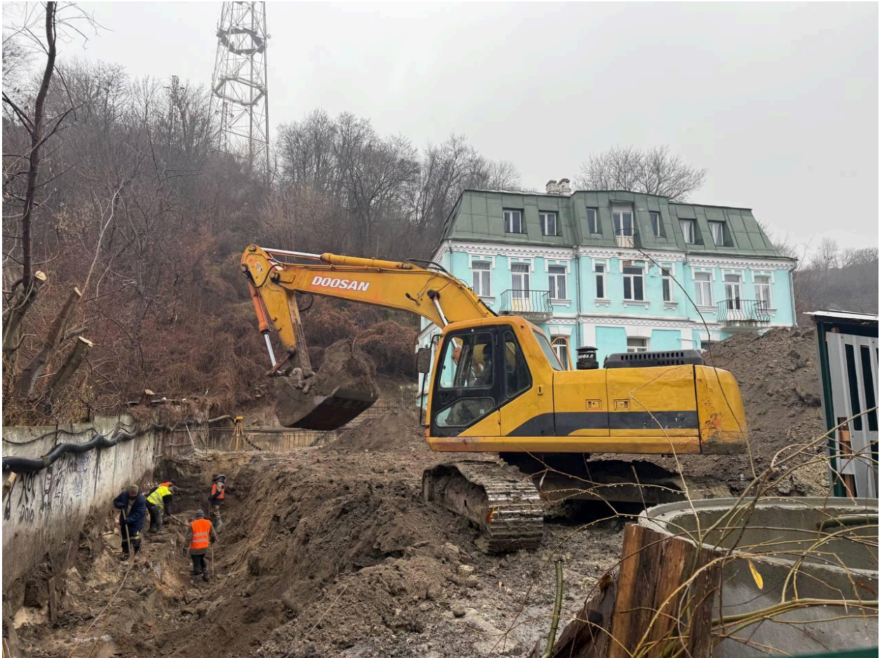
Будівельна техніка руйнує пам'ятку археології “Культурний шар Подолу, IX-XVIII ст.” (рішення Київської міської ради народних депутатів від 17.11.1987 № 1112)
