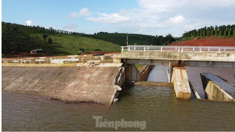
Phần thân đập bị xô, đứt gãy từng mảng bê tông – Ảnh: Tiên Phong
