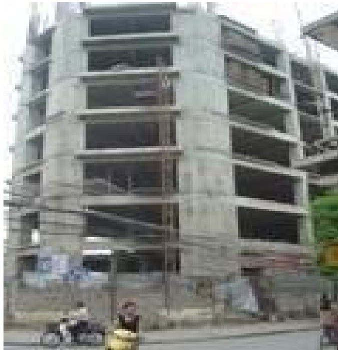
Ảnh 2.3. Công trình khu văn phòng, nhà ở tại 25 Tân Mai xây dựng không phép
