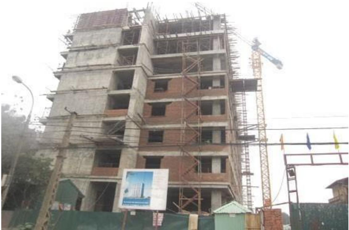
Ảnh 2.2. Công trình vi phạm trật tự xây dựng tại ngõ 83 đường Ngọc Hồi
