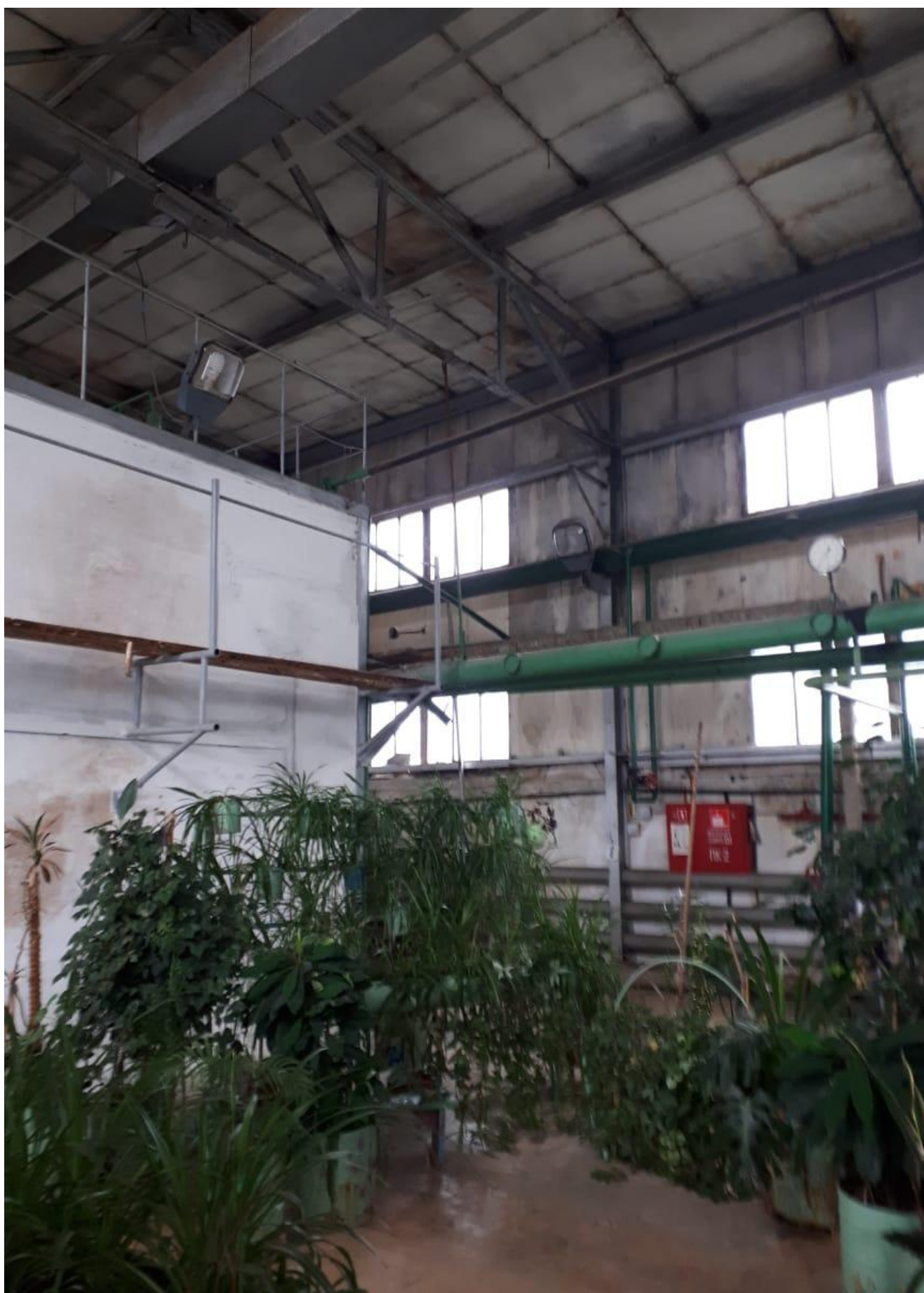
Помещение котельной №2, ул.Лермонтова,1 «а»
