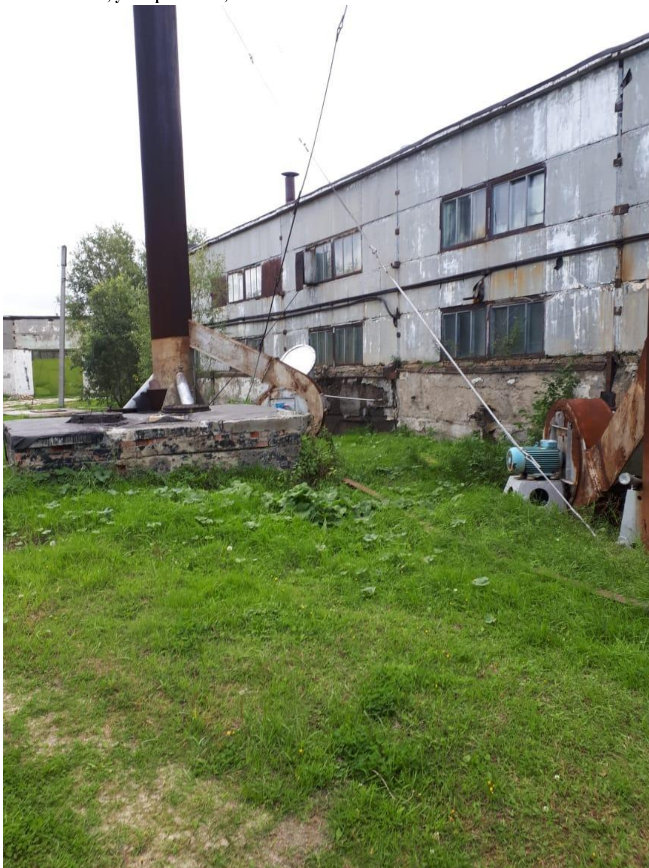
Котельная №2, ул.Лермонтова,1 «а»
