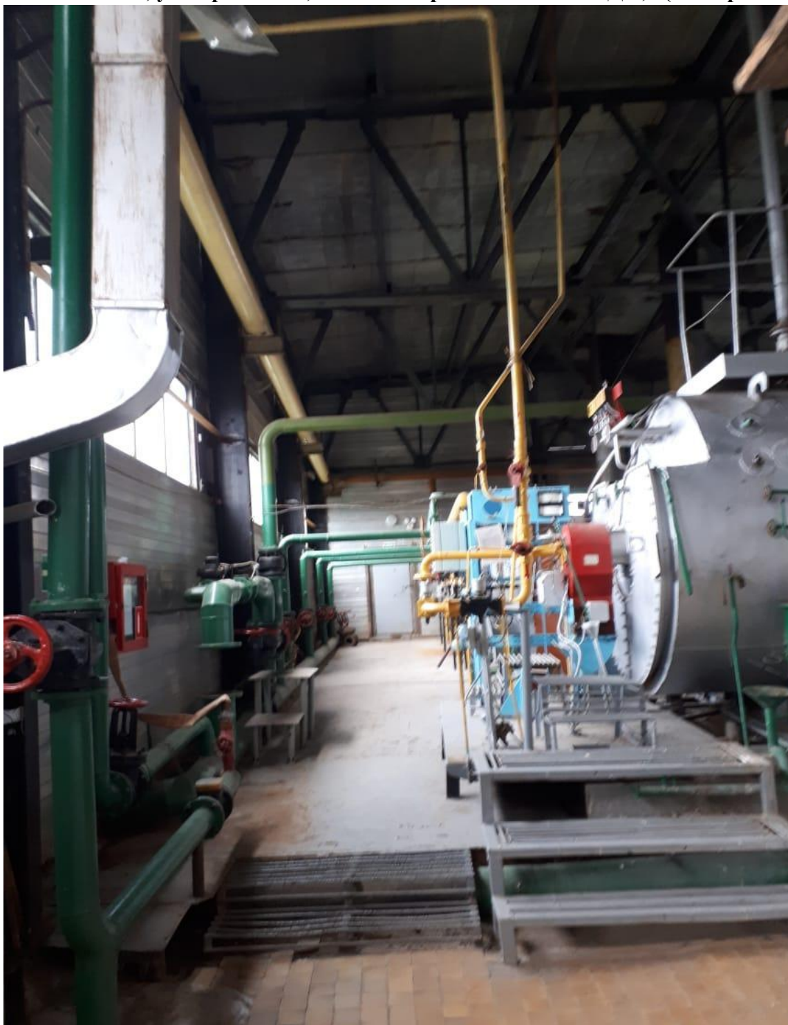
Котельная №2, ул.Лермонтова, 1»а». Водогрейные котлы ВВД-1,8 (консервация)
