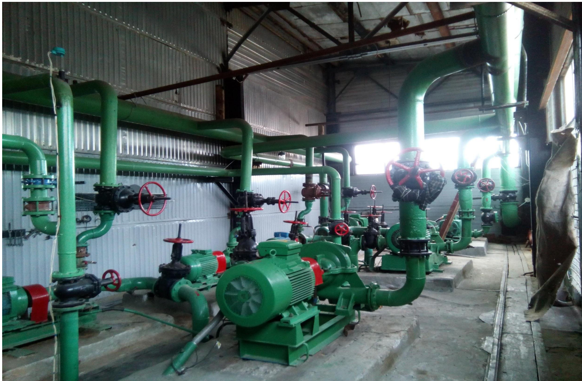
Котельная №2, ул.Лермонтова,1 «а». Насосное оборудование.
