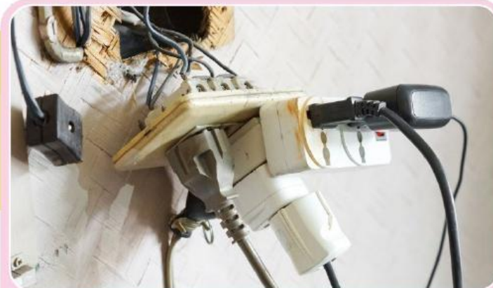
อันตรายจากไฟฟ้า
