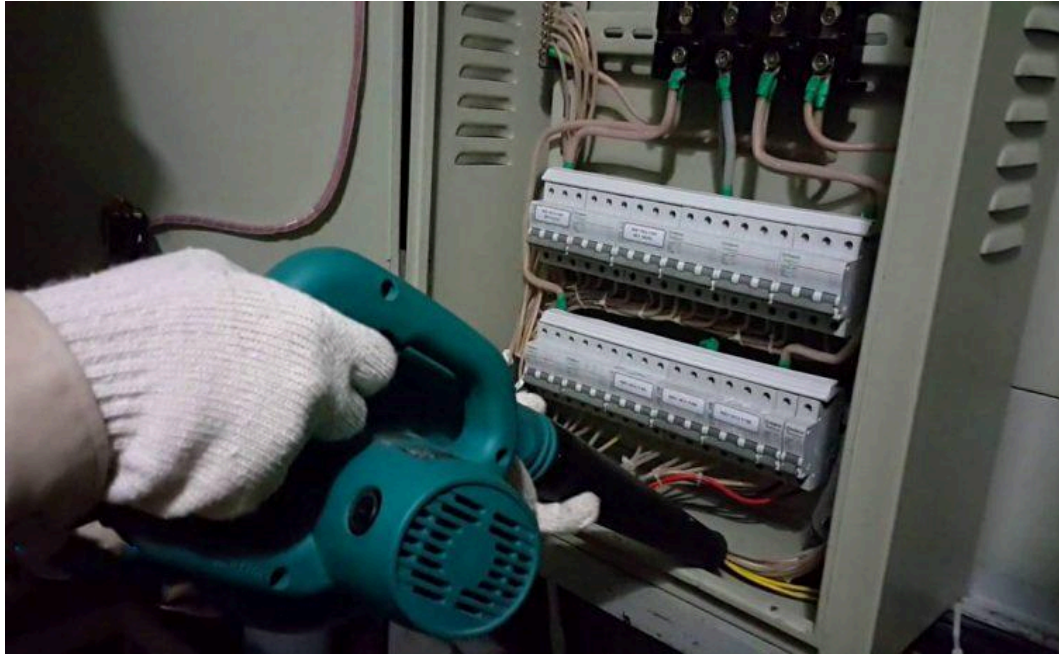
Hình ảnh vệ sinh tủ điện
